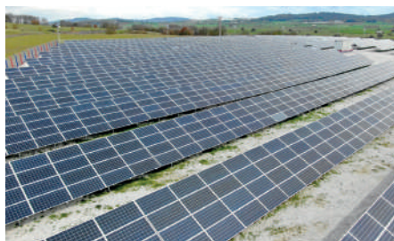
CENTRALE D'ENERGIE SOLAIRE INSTALLATION INTEGREE 1 MW AZİZOĞLU
